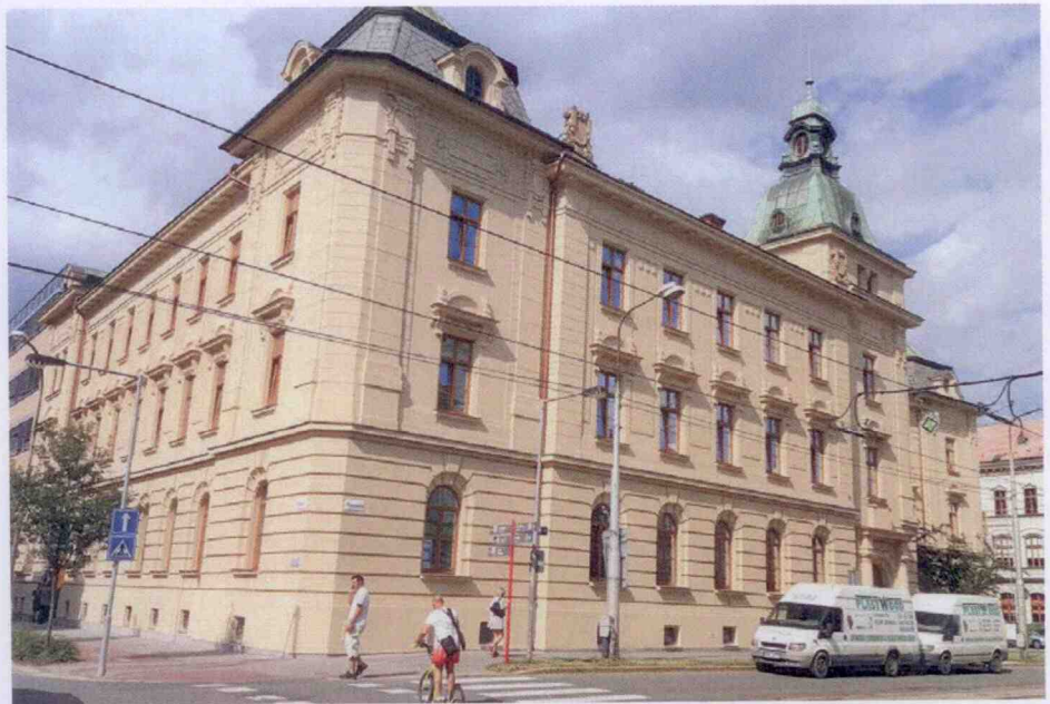
» Budova byla postavena v letech 1910 až 1911 jako sídlo Finančního ředitelství, předchozí oprava obvodového pláště proběhla v roce 1979. Foto: FN Olomouc
